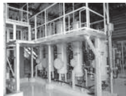
写真3 高度処理設備
