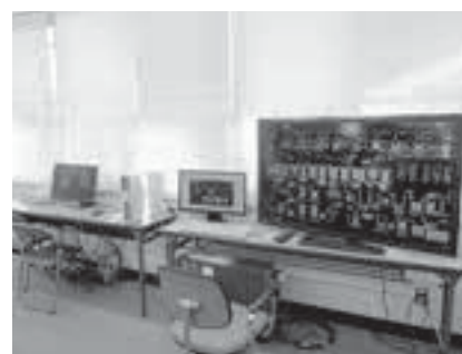
写真4 中央監視設備
